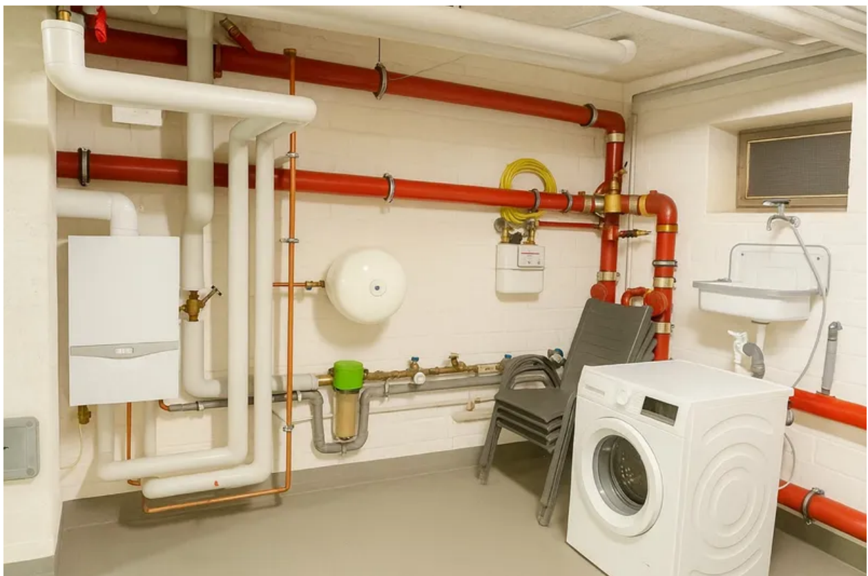
Technik im Kellergeschoss
