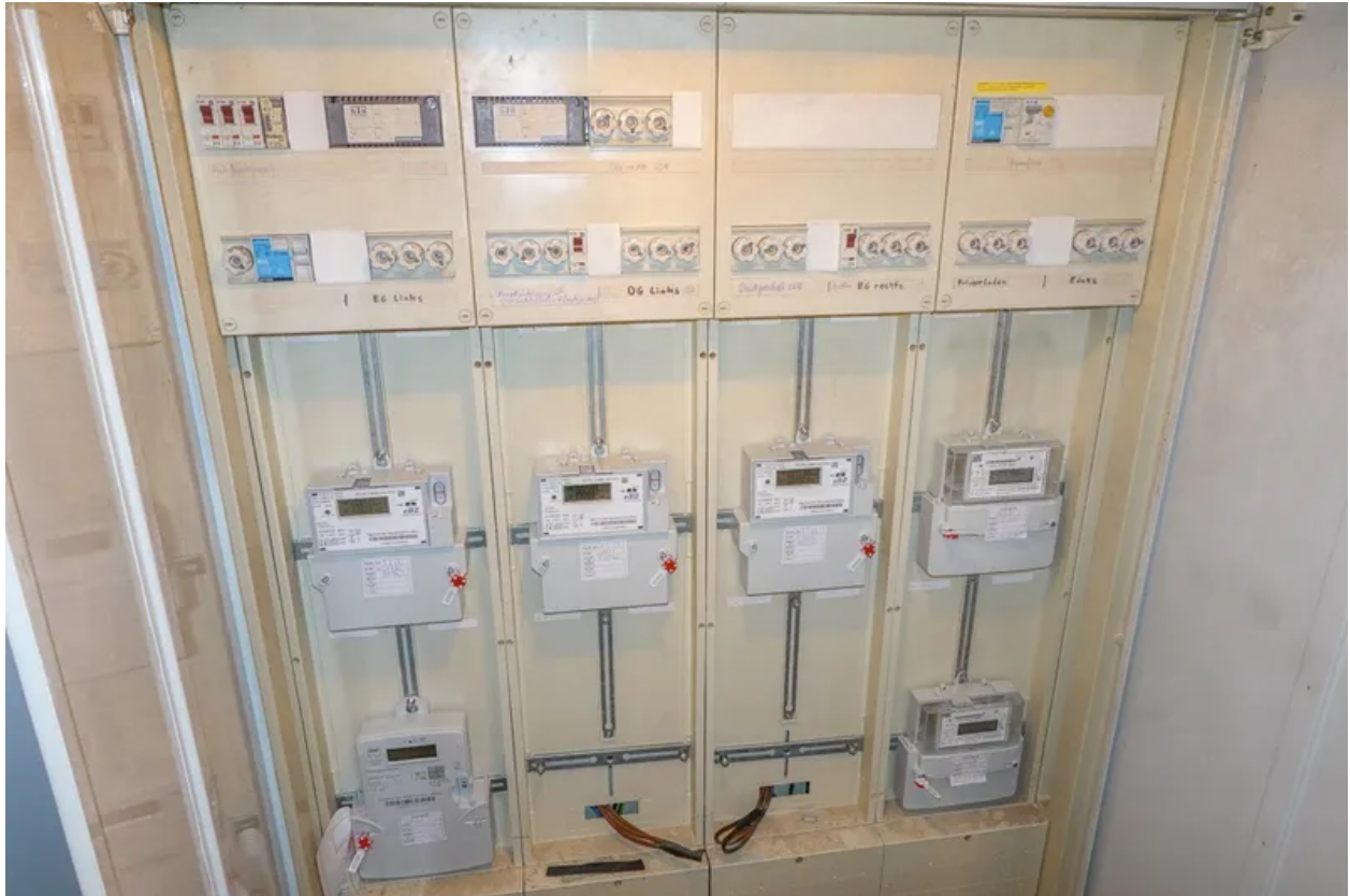
Bereits modernisierte Elektrik
