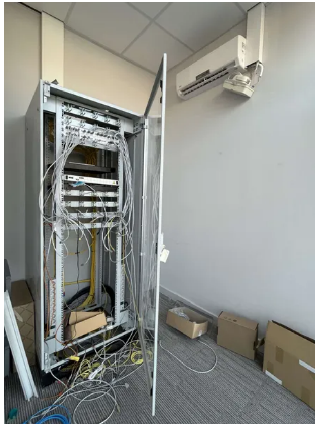
Serverraum mit -schrank
