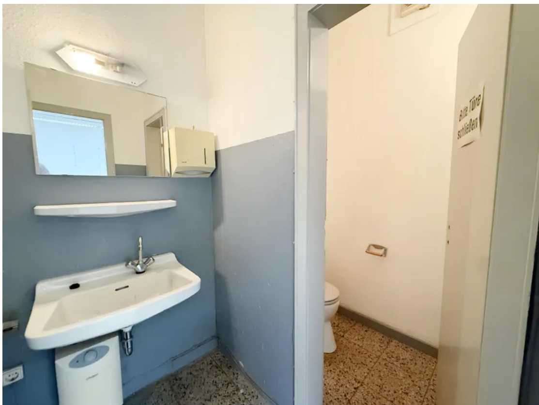
Sanitär Einheit rechts
