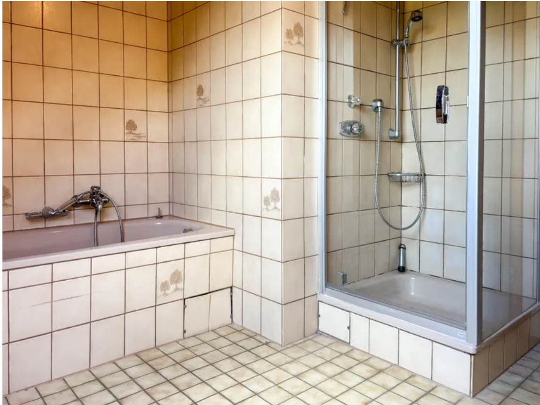
Bad DG rechts
