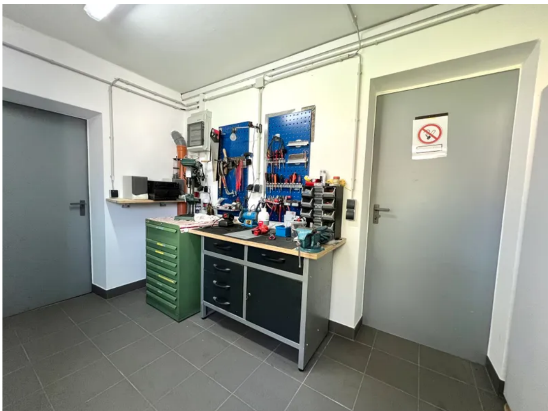
Werkraum und Luftwärmepumpe /Zugang Garage UG
